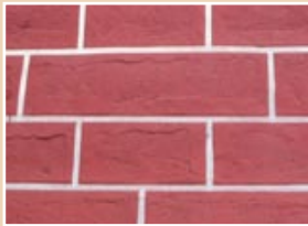
Ici les joints sont repeints de couleur grise.
